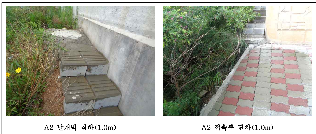
【사진 9.3.9】 교대 손상현황
